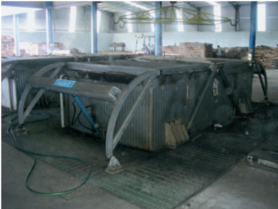
Tanques de Cozedura
